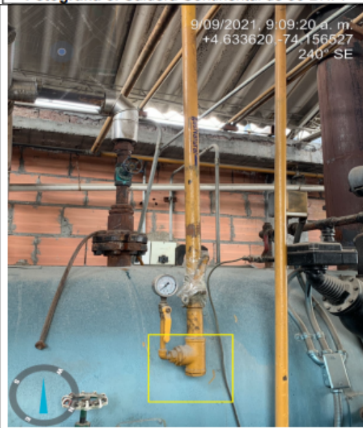
Fotografía 5. Conexión de gas natural suspendida.
