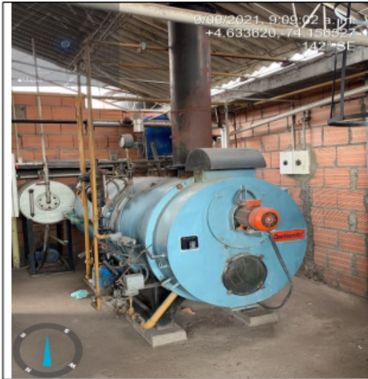
Fotografía 3. Caldera Continental de 30 BHP.
