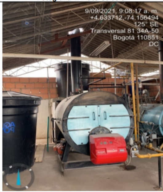
Fotografía 6. Caldera Riello de 40 BHP.
